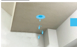
①水漏れ箇所を発見
